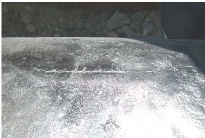
Obr. 7. Fotografie defektu (trhliny) na odkrytém a očištěném potrubí.
